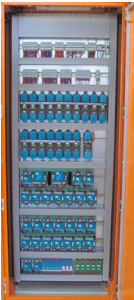
Schaltschrank für OPUS - Module Switch cabinet for OPUS modules
