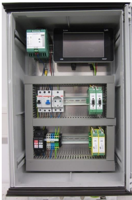
Abbildung 5: Beispiel eines Standard Lufft UMB-Schaltschranks
